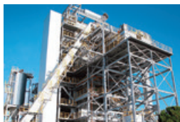
バイオマスボイラー
