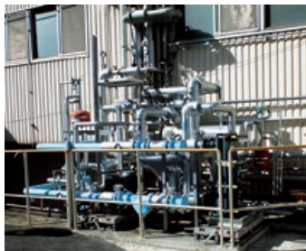
井戸水冷房ユニット
